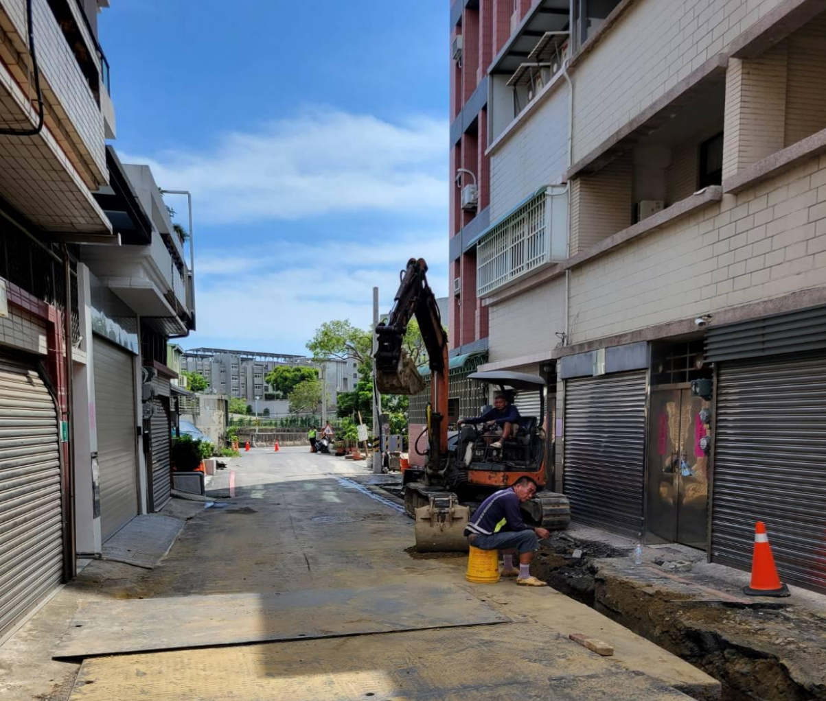
道路施工封閉處：大橋三街57巷7弄 僅限徒步可通行(搭乘火車徒步往返學校及大橋車站的學生可通行)
